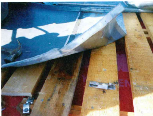
Lekkagesporen onder het felsdak in kwestie
